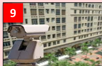
9 PEMASANGAN CCTV DI PREMIS PERNIAGAAN & TEMPAT AWAM
