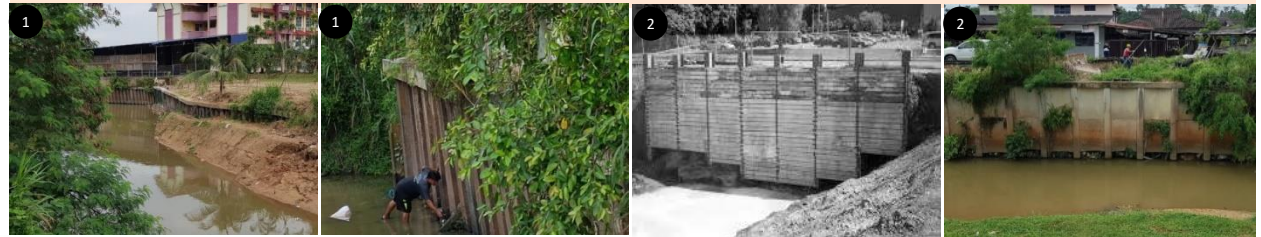
Keadaan sheet pile yang mengalami tekanan dari dalam tanah menyebabkan strukturnya berubah.
