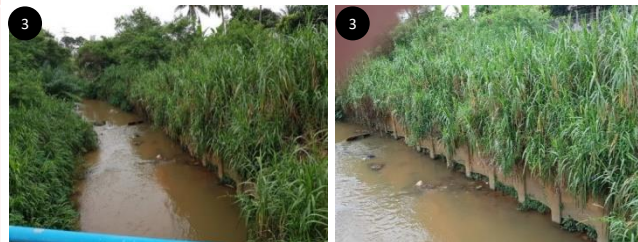
Keadaan Wallguard yang tidak dipasang mengikut spesifikasi yang betul menyebabkan sedimen mudah terkeluar ke dalam sungai.
